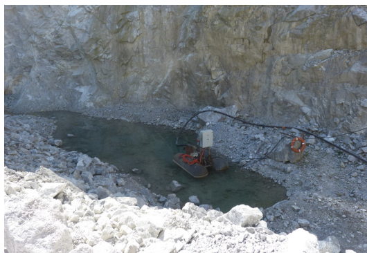
Le point de collecte des eaux d'exhaure à La Rousselière et la pompe de reprise
