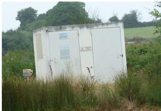
Le transformateur implanté à La Rousselière
